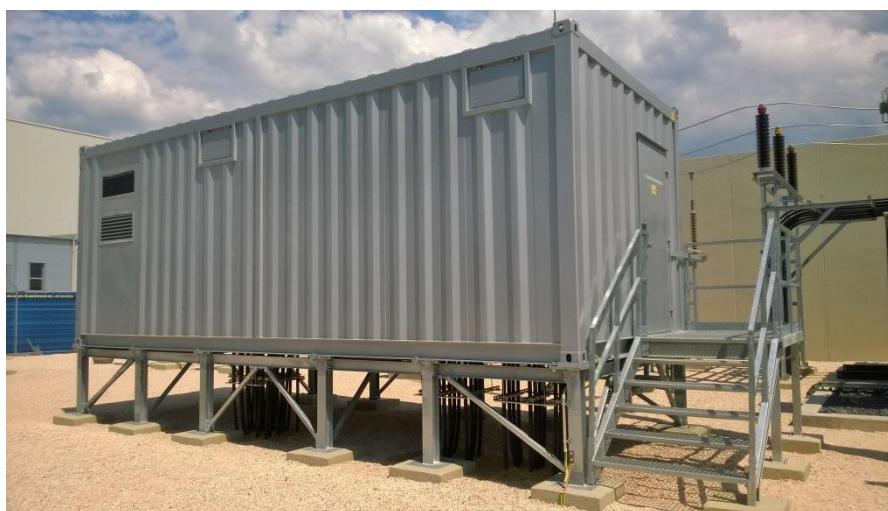
Obr.4 Malá jednokontenerová stanice
