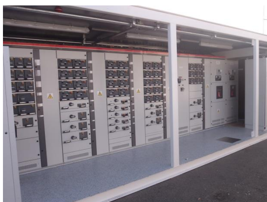
Obr.6 Rozvaděče v kontejneru
