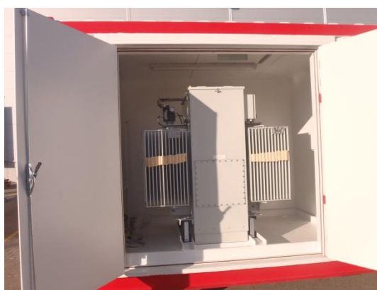
Obr.7 Transformátor v kontejneru
